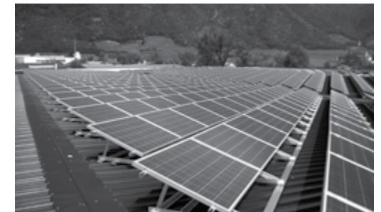
Terlan, Deutschland Montagesystem: K2 FlatRail mit Aufständersystem installierte Leistung: 230 kWp
