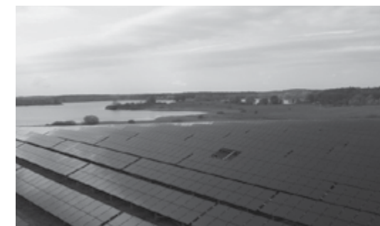
Blankenberg, Deutschland Montagesystem: N-Rack Installierte Leistung: 1,1 MW
